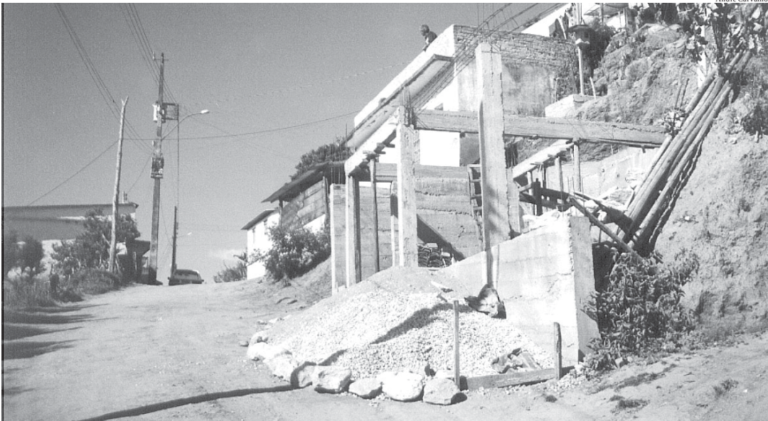
Rua Crispim Nézio ainda precisa de obras da prefeitura
