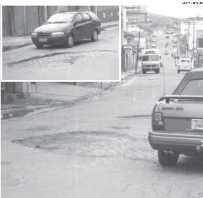
Buracos incomodam motoristas e moradores na rua Thomaz Gonzaga
